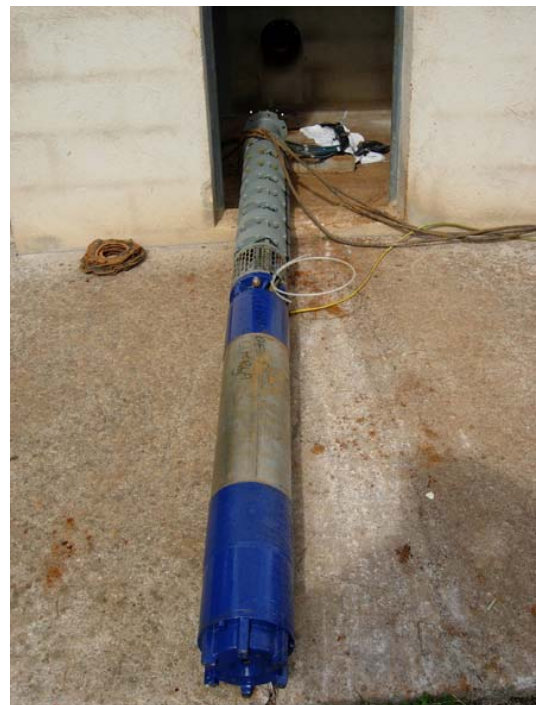
Electrobomba de 60 C.V
