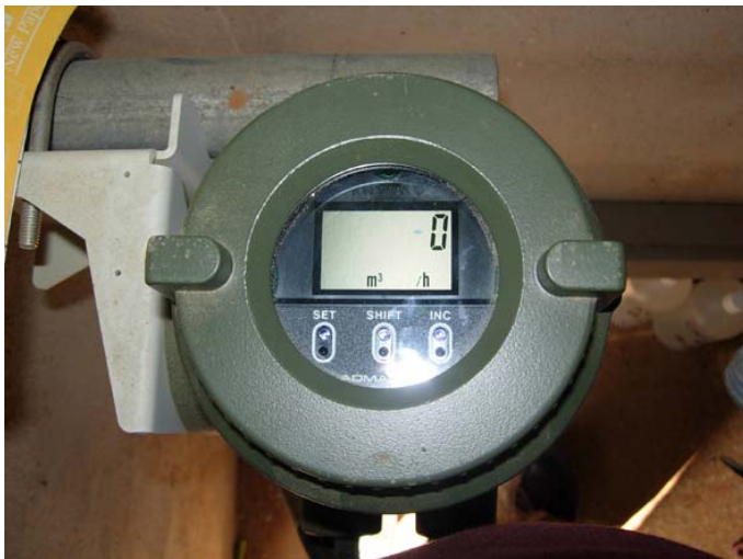
Caudalímetro y contador de volumen marca ADMG
